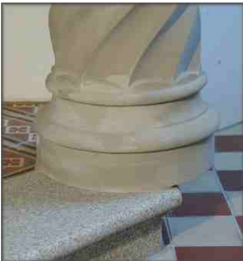
Der Sandsteinfuß. Ob das so geplant war?
